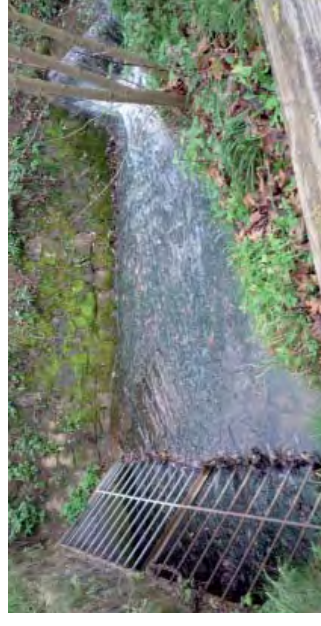
Einschöpfwerk am Beginn der Verrohrung des Steinbachs
